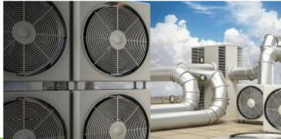
اعمال الكهرو ميكانيكا و انظمة الحريق و التكييف و التبريد
